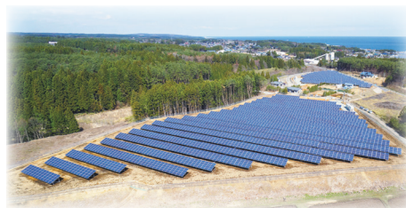
稼働中の弊社 洋野町メガソーラー
